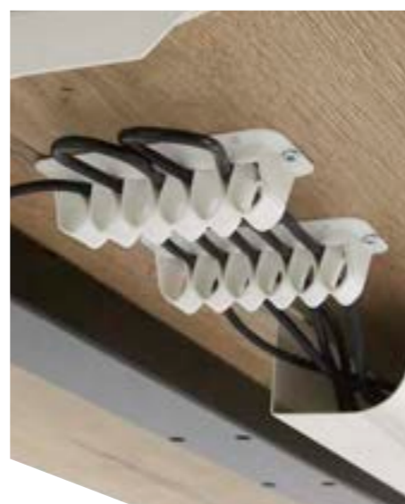
Kabelmanagement onder de werkplek
